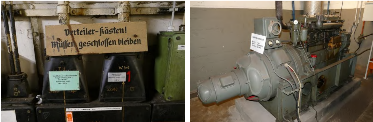
Abb. 20: Elektroverteiler und Notstromaggregat heute [J. Baur]
